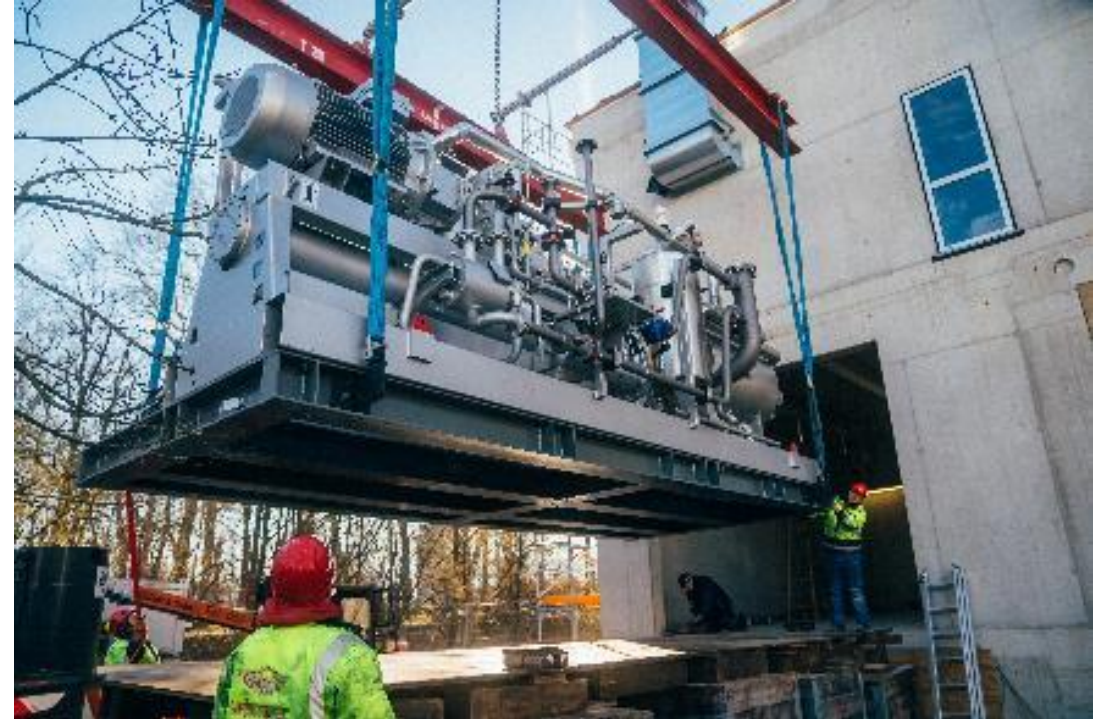
Foto: Stadtwerke Rosenheim / BWP
